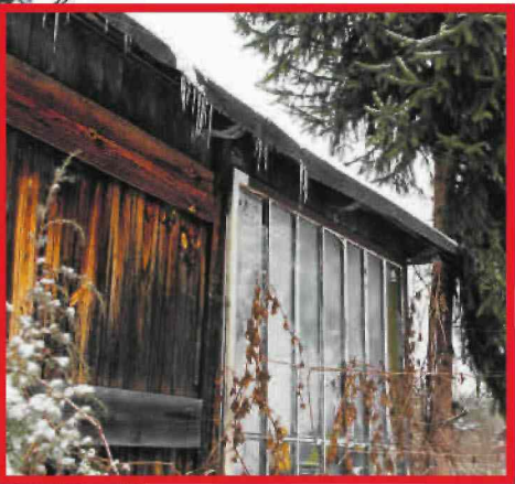
► Dom przed remontem wyglądał bardzo źle.
